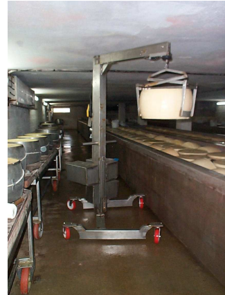
Fig. 17 - salatoio collocato in locale molto basso con soluzione progettata ad hoc (distanza tra sollevatore e soffitto < 5 cm)
