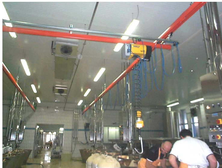
Fig. 9 – esempio di spazio sovrastante la caldaia sgombrato ed adeguato per guidovia con azzeratore di peso che serve due file di caldaie
