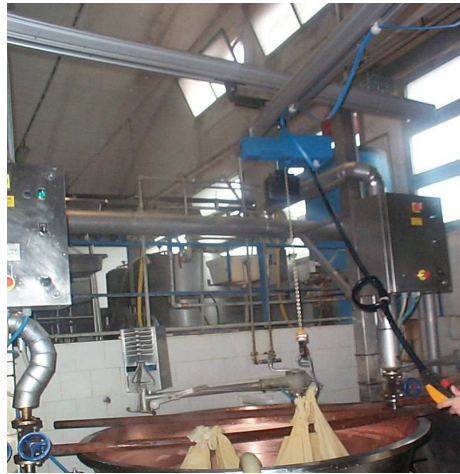
Fig. 7 – esempio di spazio sovrastante la caldaia sgombrato ed adeguato
